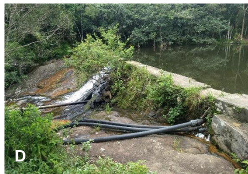
D Captação de água pública / CASAN
